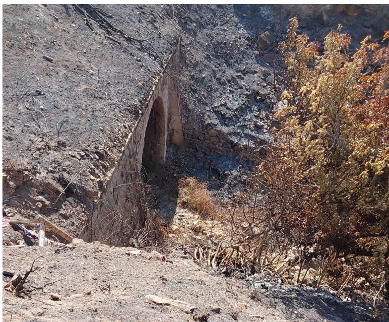
Figura 44. El Barranc d'Aigualit, cruza la CV-2281 con el encauzamiento que se muestra en la figura. Este barranco tiene una longitud de 3,75 km y drena una superficie de 225 ha. Se recomienda analizar la capacidad de arrastre de troncos y elementos grueso que puedan obturar el drenaje en caso de fuertes precipitaciones.
